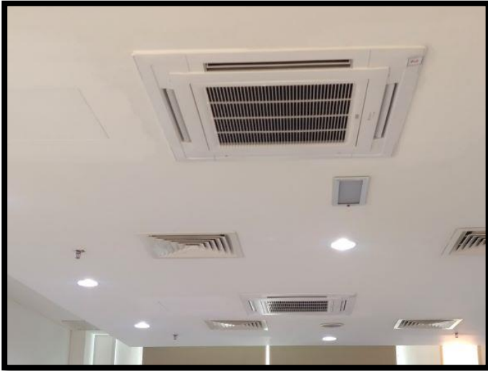
Menggunakan split air cond di Bilik Seminar 1 dan 2, Bangunan PRZS
